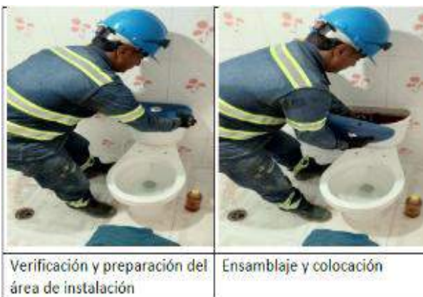
Imagen 91 Norma Instalar Aparatos Sanitarios De Acuerdo Con Planos Y Normativa Técnica
